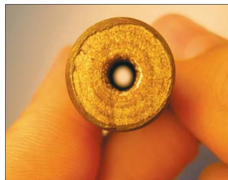
Рис. 2. Отложение солей в трубке бойлера ГВС
