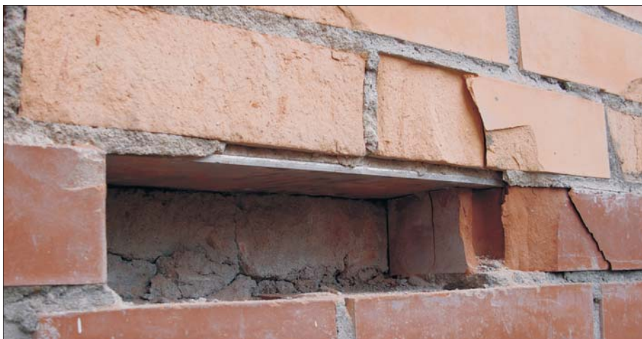
Повреждение облицовки в опорной зоне
