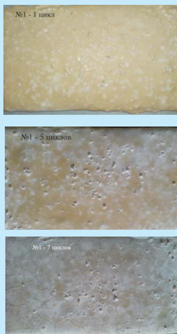
Фото 3. Состояние поверхности защитного покрытия состава №1 после 1, 5 и 7 циклов старения
