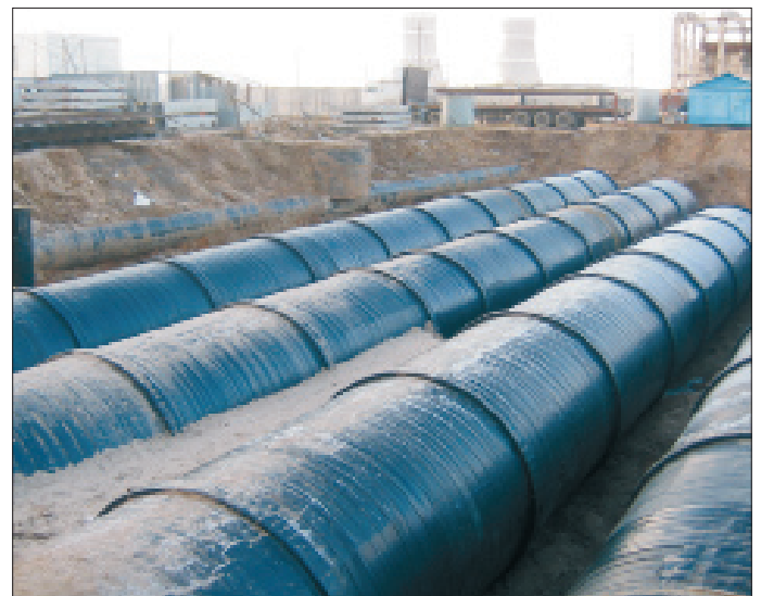
Трубопроводы подачи воды (Калининская АЭС, 2008г.)
