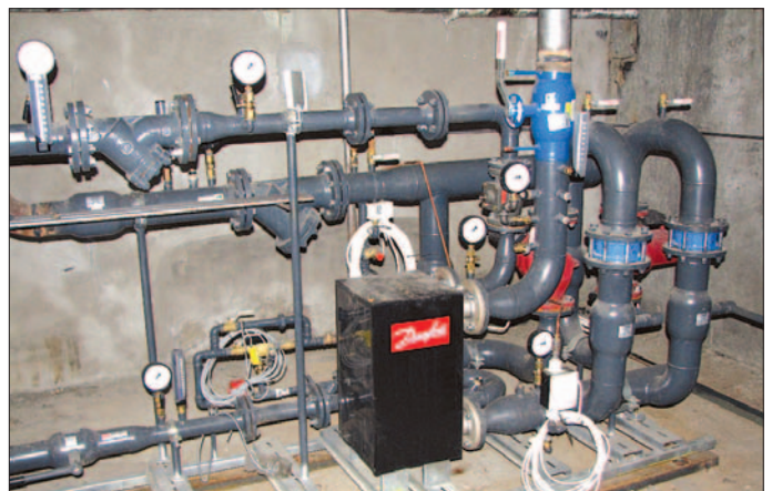
Блочный тепловой пункт в подвале многоквартирного дома
